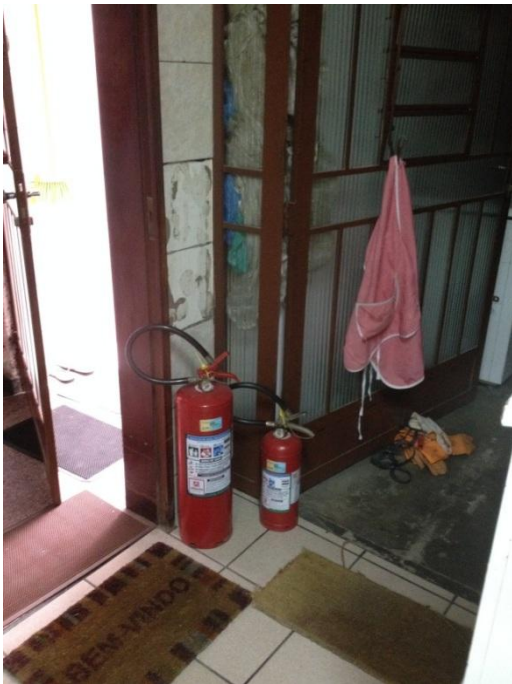
Figura 10: Extintores de Incêndio – Setor Produção
