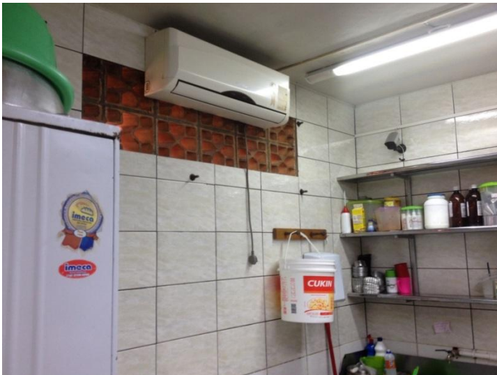
Figura 13: Entrada/saída de ar 3 e Ar-condicionado
