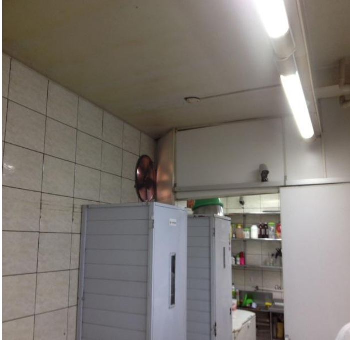
Figura 12: Entrada/saída de ar 2
