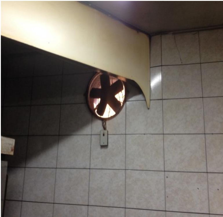
Figura 11: Entrada/saída de ar 1
