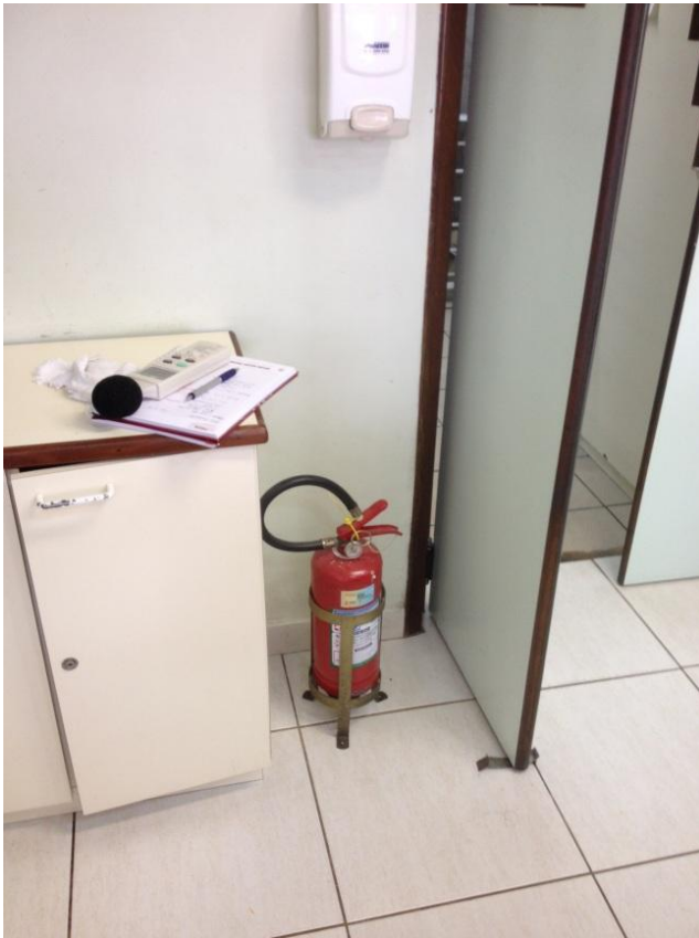
Figura 3: Extintor de Incêndio – Setor Atendimento
