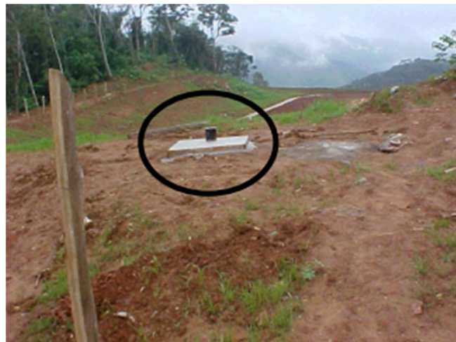
Figura 5 - Aterro do Rocha: tubulação do ponto de inspeção para coleta de água para análise
