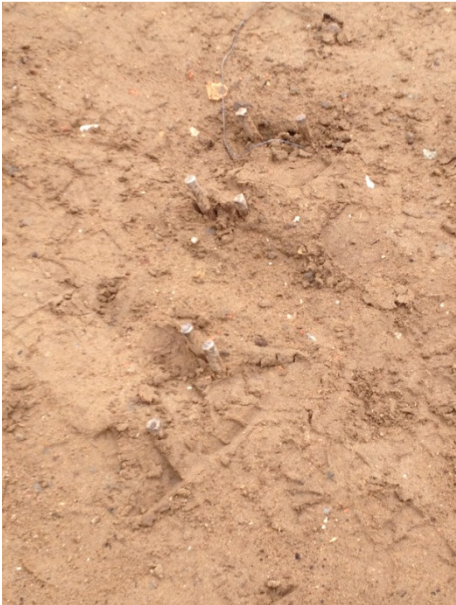
Figura 41: Pontas de vergalhões de aço expostas. Fonte: Arquivo pessoal, 2014.
