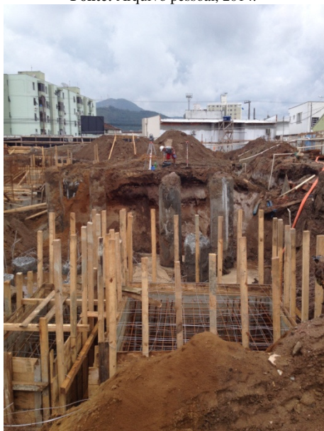
Figura 27: Ausência de escoramento em profundidades maiores que 1,75 m. Fonte: Arquivo pessoal, 2014.
