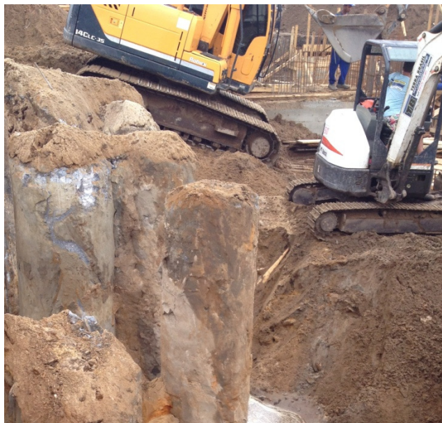
Figura 58: Máquinas operando com comprometimento da estabilidade.
