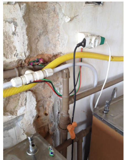
Figura 49: Instalações elétricas adaptadas e expostas. Fonte: Arquivo pessoal, 2014.
