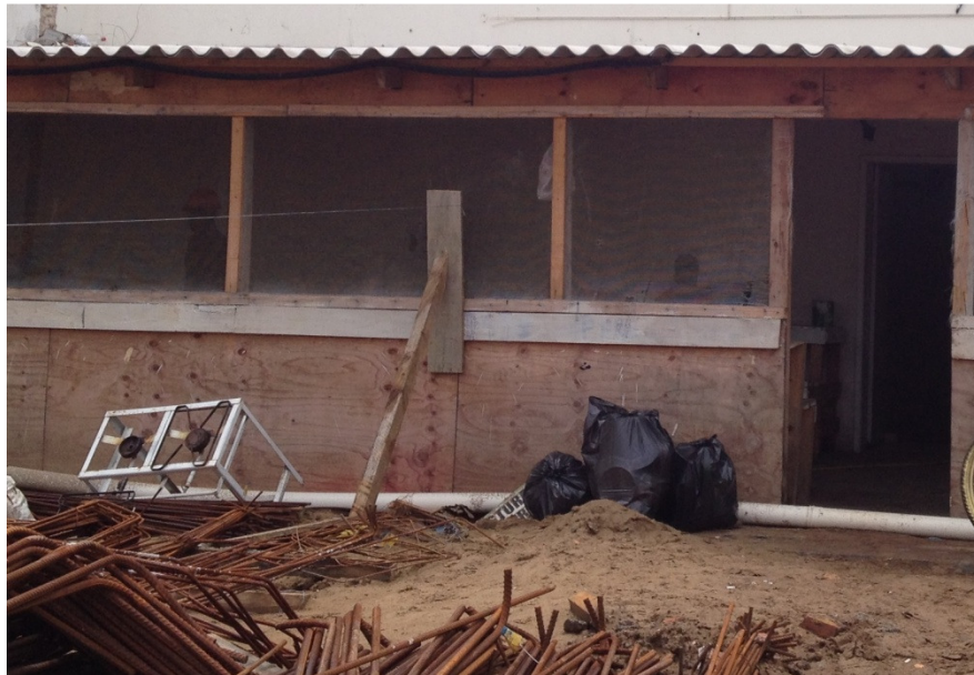
Figura 66: Resíduos e ferramenta para aquecimento dispostos em local inadequado.
