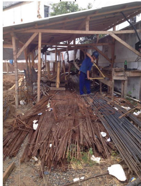
Figura 62: Ferragens sobre piso úmido e desnivelado. Fonte: Arquivo pessoal, 2014.
