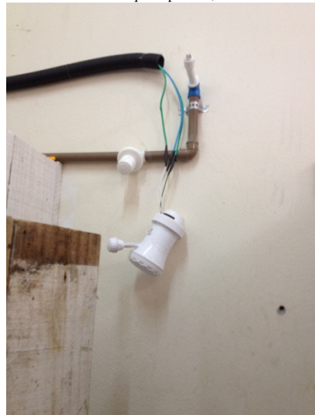
Figura 12: Necessidade de manutenção no chuveiro. Fonte: Arquivo pessoal, 2014.
