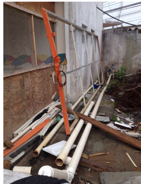
Figura 68: Materiais dispostos de maneira e local inadequado.
