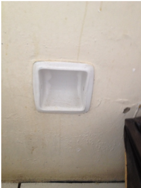
Figura 15: Ausência de papel higiênico no sanitário. Fonte: Arquivo pessoal, 2014.
