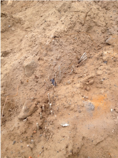
Figura 45: Pontas de vergalhões de aço expostas. Fonte: Arquivo pessoal, 2014.
