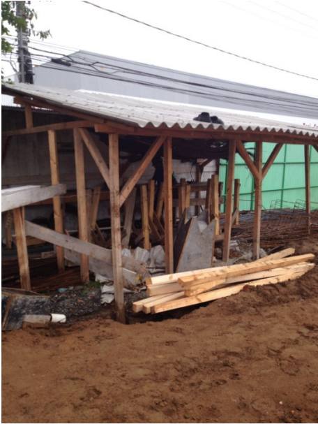
Figura 39: Local das armações de aço - falta iluminação. Fonte: Arquivo pessoal, 2014.
