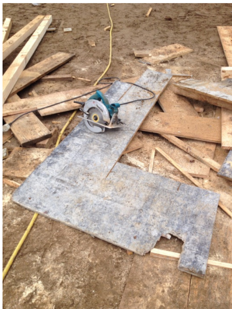
Figura 35: Local de utilização da serra circular - a mesma não contém dispositivo para coleta de serragem. Fonte: Arquivo pessoal, 2014.
