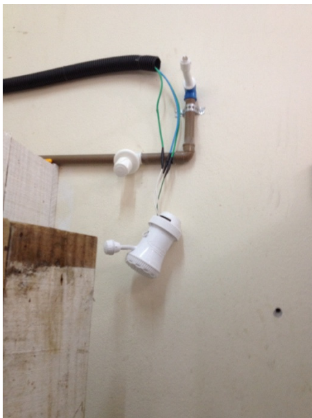
Figura 48: Instalações elétricas expostas. Fonte: Arquivo pessoal, 2014.
