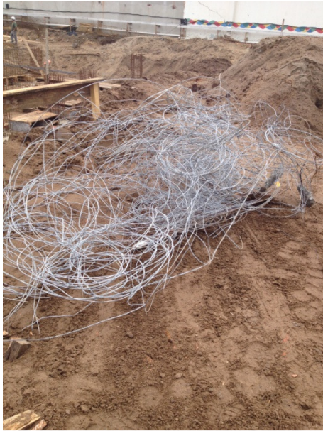
Figura 69: Fios de arame dispostos em local inadequado. Fonte: Arquivo pessoal, 2014.
