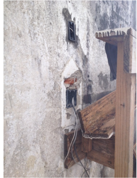
Figura 51: Partes vivas de circuito expostas. Fonte: Arquivo pessoal, 2014.
