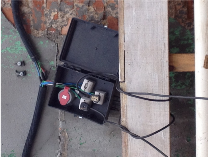
Figura 50: Quadro de apoio - deve permanecer fechado. Fonte: Arquivo pessoal, 2014.
