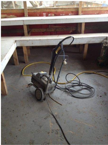
Figura 53: Equipamento fora de utilização na via de circulação.
