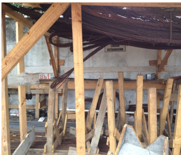
Figura 37: Local das armações de aço - materiais não são adequadamente apoiados junto ao teto. Pregos expostos sobre as madeiras. Fonte: Arquivo pessoal, 2014.
