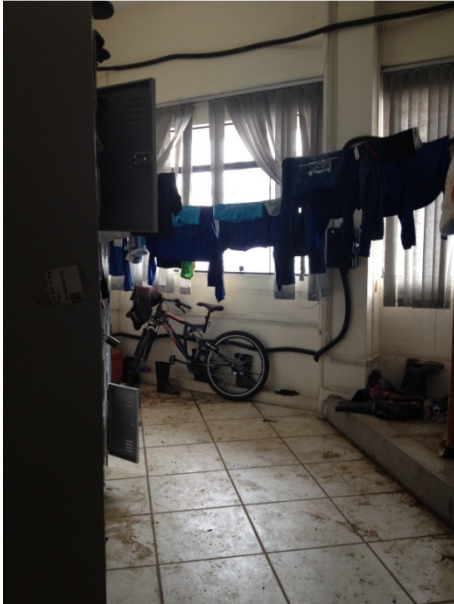
Figura 3: Oportunidade de melhorias na higiene e limpeza do vestiário.
