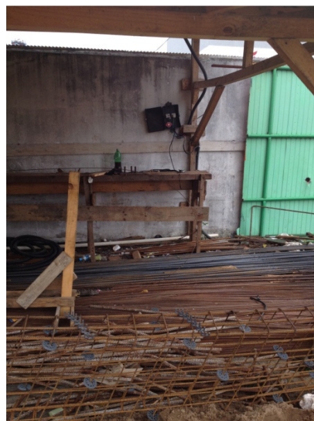
Figura 38: Local das armações de aço - armações depositadas em local inadequado Fonte: Arquivo pessoal, 2014.
