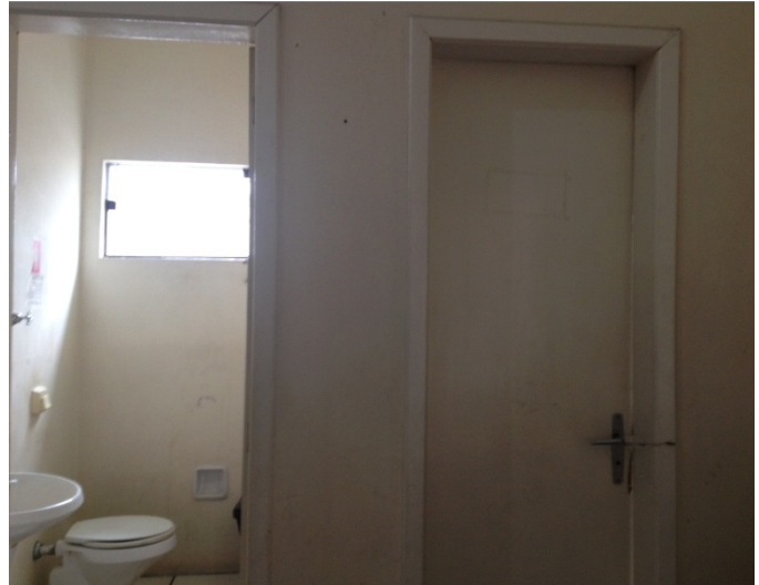
Figura 10: Número insuficiente de vasos sanitários, lavatórios e mictórios para os funcionários. Fonte: Arquivo pessoal, 2014.
