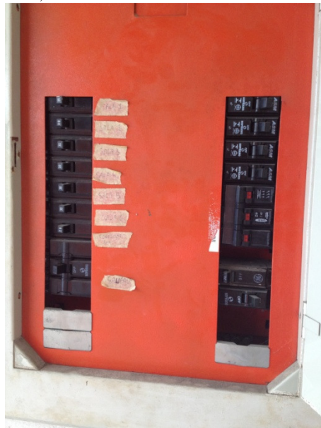
Figura 52: Quadro de comando não permanece trancado e seus circuitos não são adequadamente identificados. Fonte: Arquivo pessoal, 2014.
