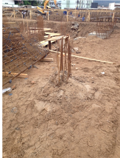
Figura 46: Pontas de vergalhões de aço expostas. Fonte: Arquivo pessoal, 2014.
