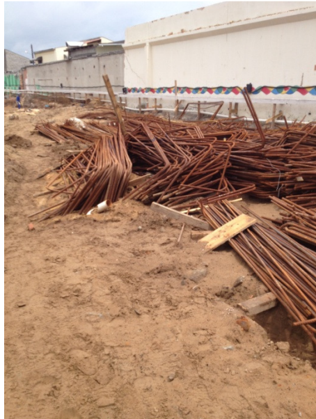
Figura 65: Materiais dispostos de maneira inadequada. Fonte: Arquivo pessoal, 2014.
