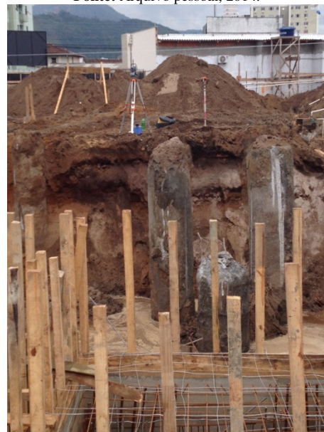
Figura 28: Ausência de escoramento em profundidades maiores que 1,75 m. Fonte: Arquivo pessoal, 2014.
