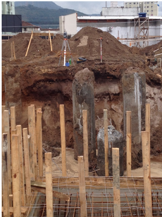
Figura 47: Ausência de mecanismos contra queda em alturas superiores à 2,0 metros. Fonte: Arquivo pessoal, 2014.
