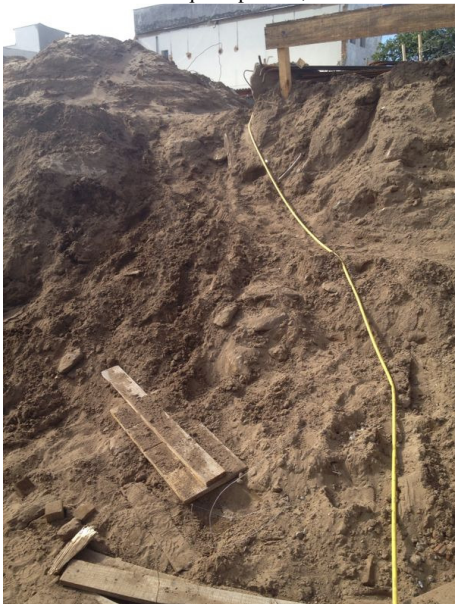
Figura 31: Ausência de rampa ou escada. Fonte: Arquivo pessoal, 2014.
