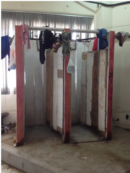
Figura 11: Número insuficiente de chuveiros em funcionamento. Fonte: Arquivo pessoal, 2014.
