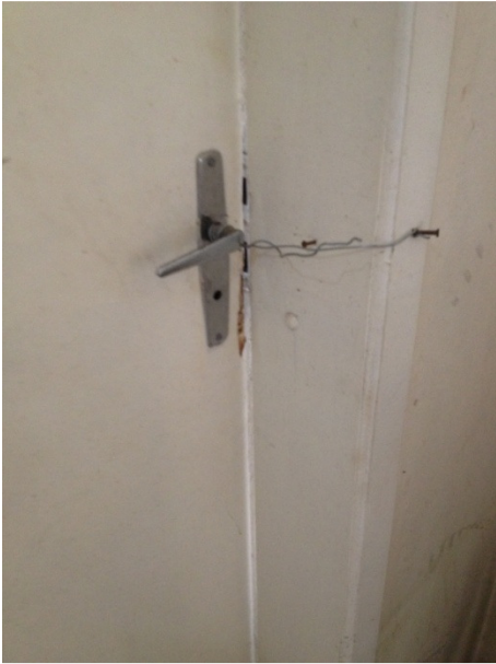
Figura 9: Banheiro com necessidade de manutenção. Fonte: Arquivo pessoal, 2014.
