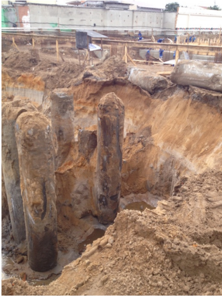
Figura 29: Ausência de escoramento em profundidades maiores que 1,75 m. Fonte: Arquivo pessoal, 2014.
