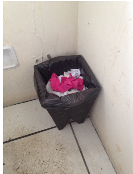
Figura 16: Ausência de tampa no depósito de papéis usados. Fonte: Arquivo pessoal, 2014.
