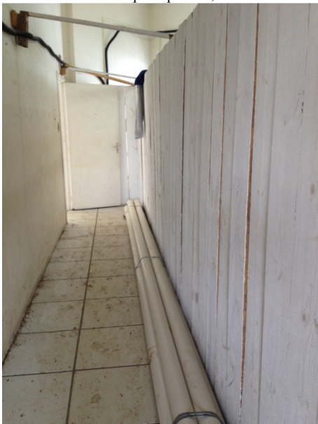
Figura 61: Tubulação disposta em local de circulação (corredor). Fonte: Arquivo pessoal, 2014.
