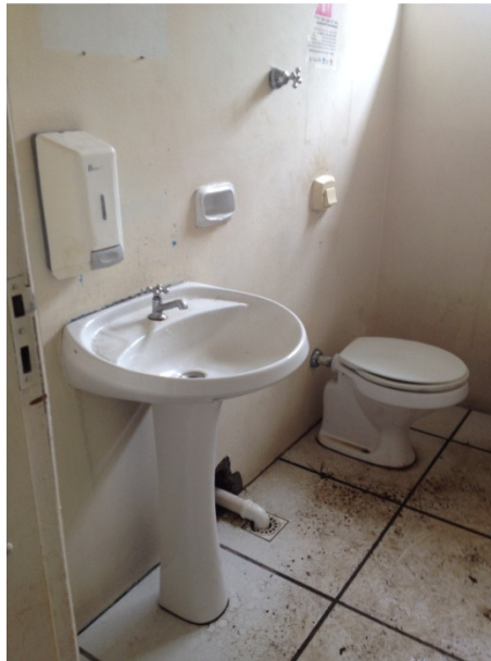
Figura 14: Ausência papel toalha e de recipiente para coleta de papéis usados no lavatório. Fonte: Arquivo pessoal, 2014.
