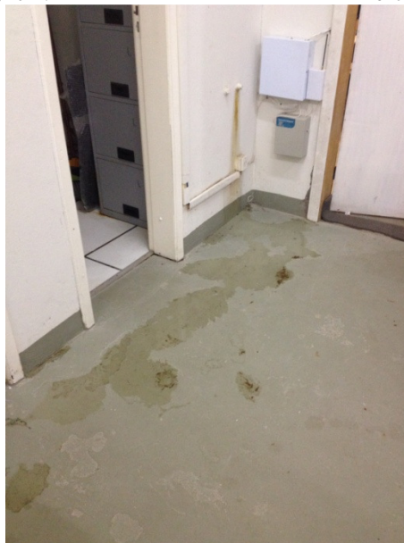
Figura 22: Observado vazamento no piso inferior, proveniente dos alojamentos. Fonte: Arquivo pessoal, 2014.
