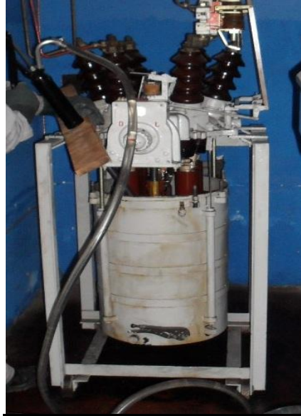
Figura 26 - Disjuntor DJ-SE CALDEIRA. FONTE: O autor, 2014.
