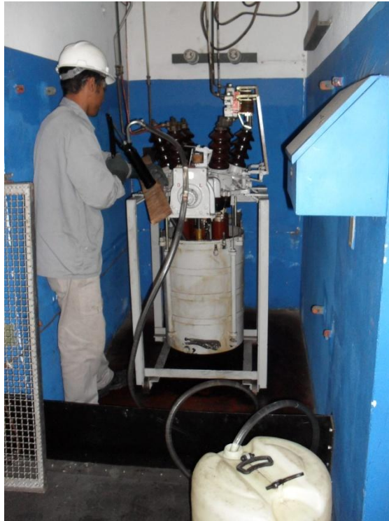
Figura 28 - Troca de óleo disjuntor DJ-SE CALDEIRA. FONTE: O autor, 2014
