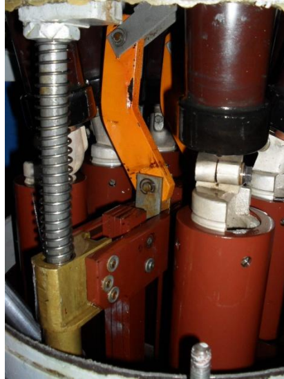
Figura 27 - Contatos internos do Disjuntor DJ-SE CALDEIRA. FONTE: O autor, 2014
