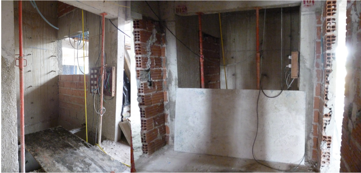
Figura 8 – Detalhe das instalações elétricas. Fonte: O autor (2014)
