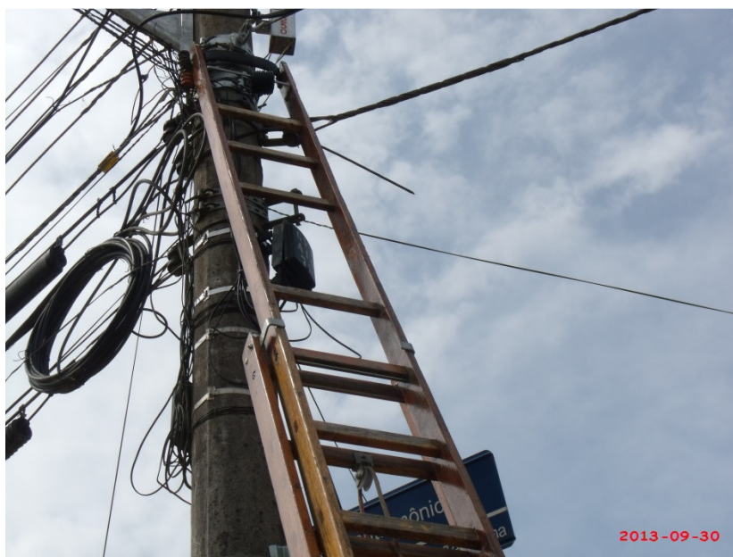
Figura 23 - Escada Extensível com um dos Degraus Quebrado
