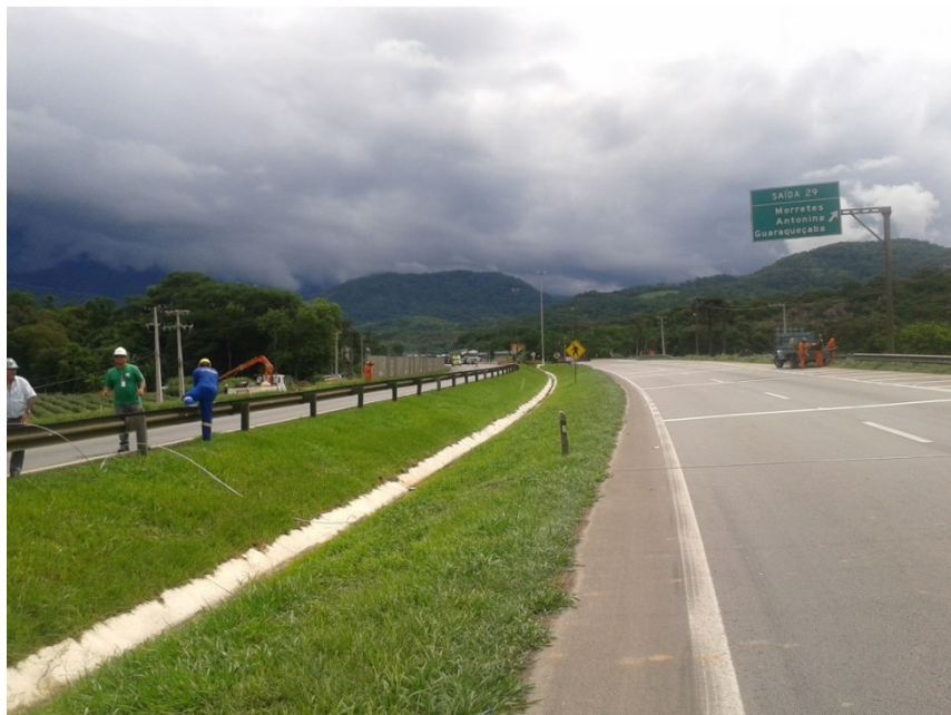
Figura 35 - Trânsito Interrompido e Cabo Óptico no Chão
