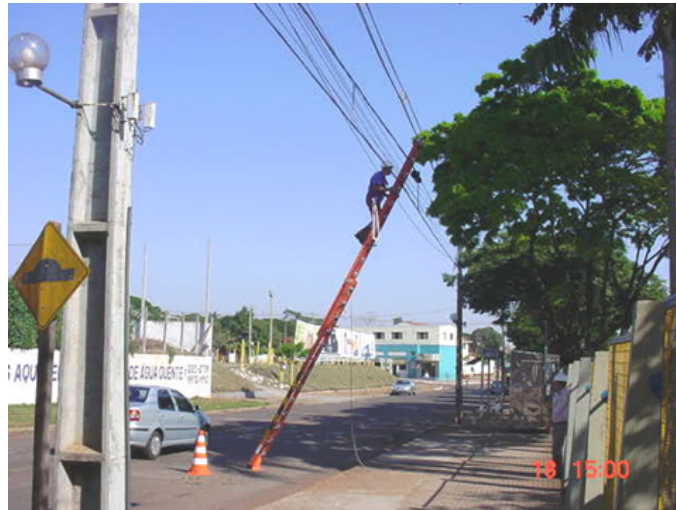
Figura 27 - Sinalização da Escada em Avenida
