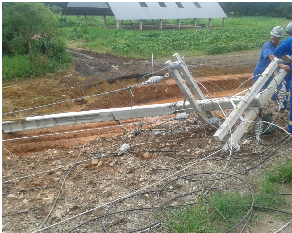
Figura 34 - Poste Caído ao Lado de Rodovia
