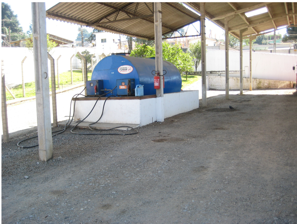
Figura 4: Tanque de óleo diesel instalado no “Empreendimento B”
