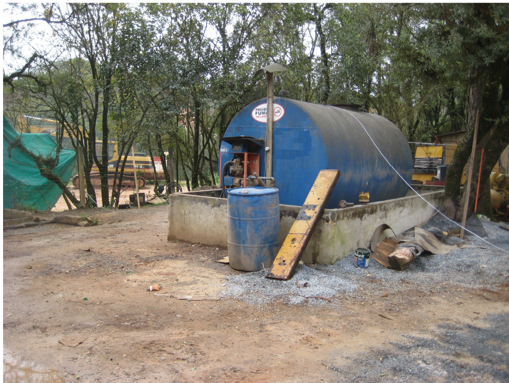
Figura 3: Tanque de óleo diesel instalado no “Empreendimento A”
