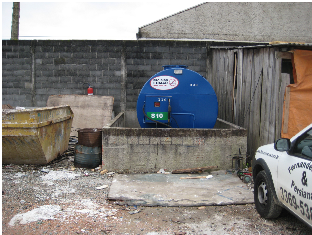
Figura 9: Tanque de óleo diesel instalado no “Empreendimento G”
