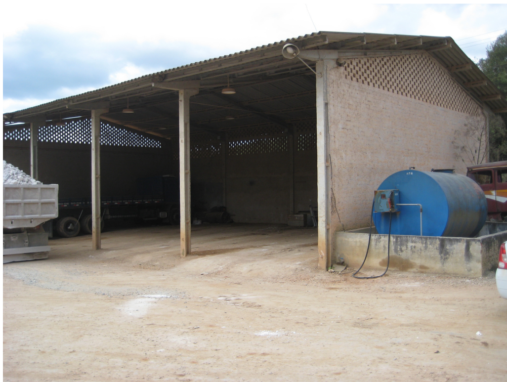
Figura 7: Tanque de óleo diesel instalado no “Empreendimento E”
