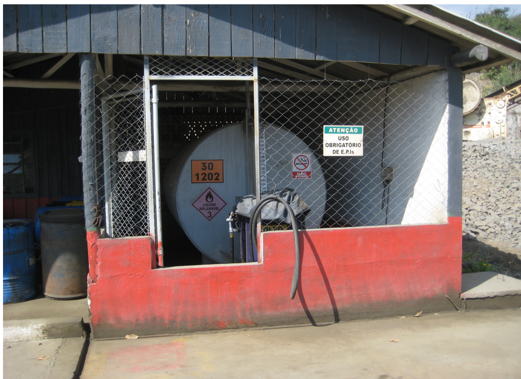
Figura 5: Tanque de óleo diesel instalado no “Empreendimento C”
