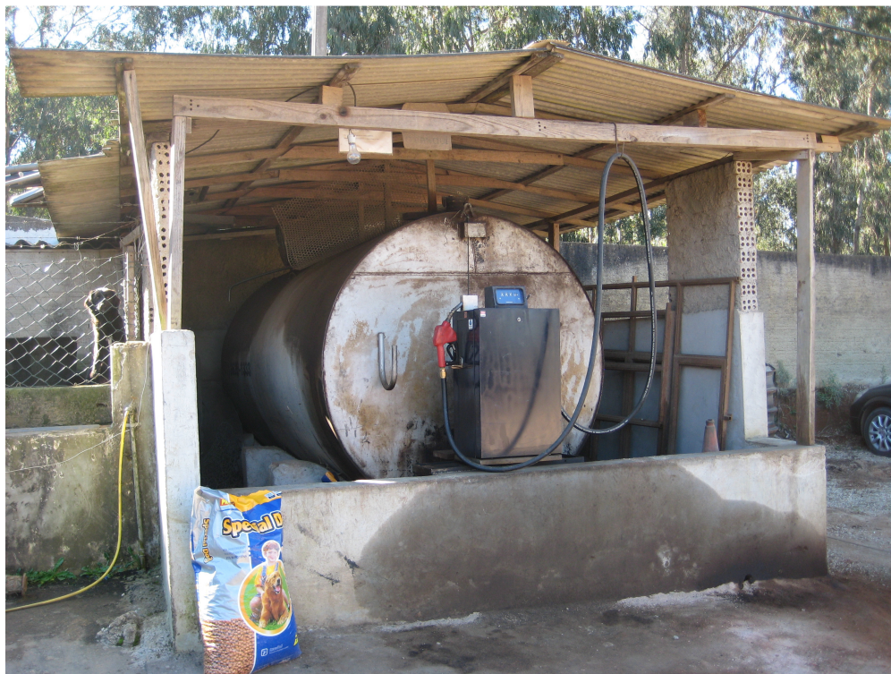
Figura 8: Tanque de óleo diesel instalado no “Empreendimento F”
