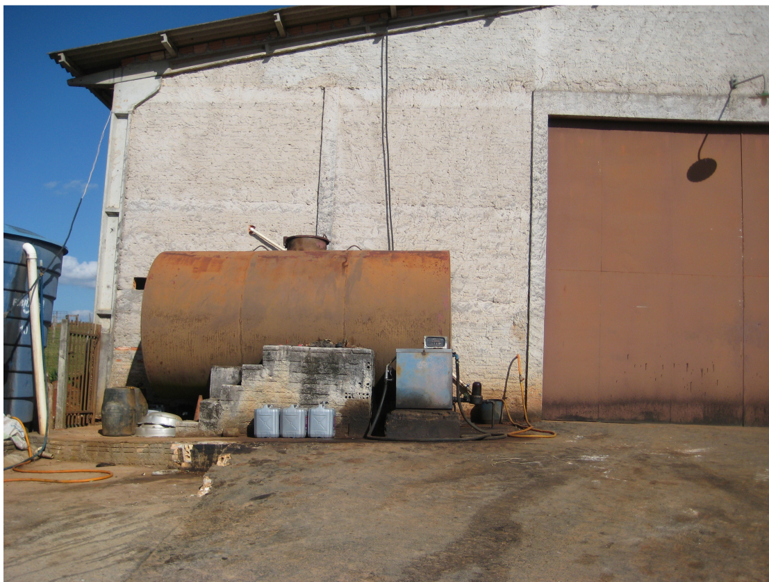
Figura 6: Tanque de óleo diesel instalado no “Empreendimento D”
