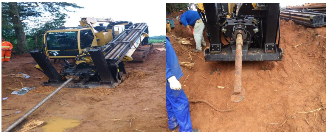
Figura 1- Perfuratriz (esquerda) e lança da Perfuratriz(direita)
