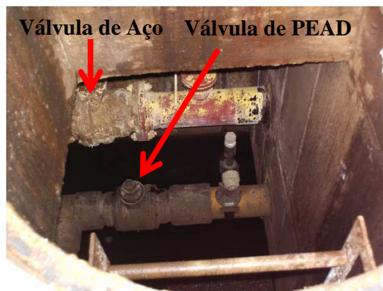
Figura 6: Válvulas de Bloqueio Fonte: Autor
