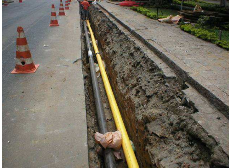
Figura 5: Tubulação de Aço na cor “preta” e Tubulação de PEAD na cor “amarela” Fonte: Autor
