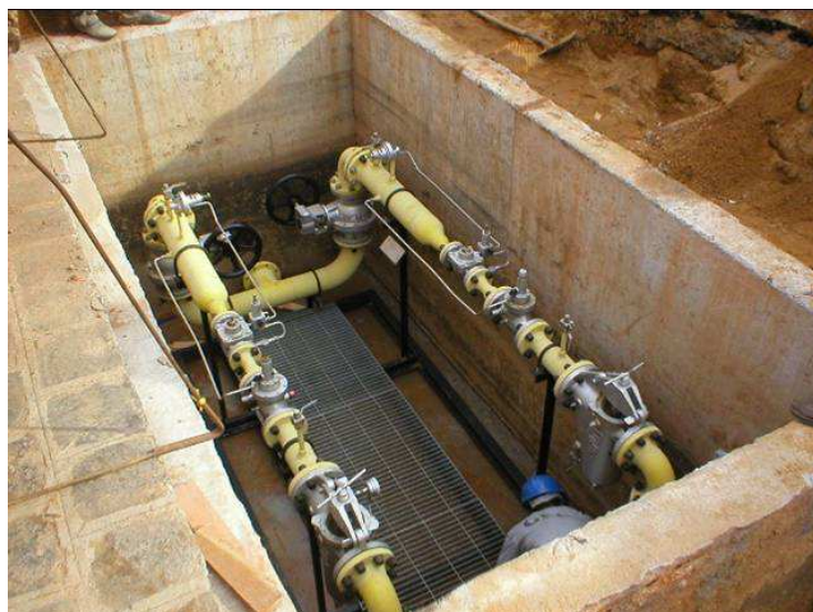
Figura 7: Instalação de ERP –Estação de Redução de Pressão
