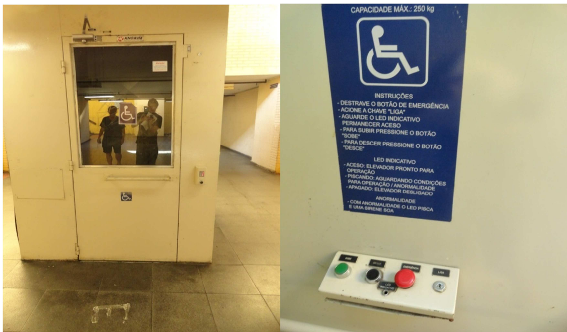
Figura 39 - Plataformas atendendo parcialmente a norma ABNT NBR 90050/2015 Fonte: Autor (2016)
