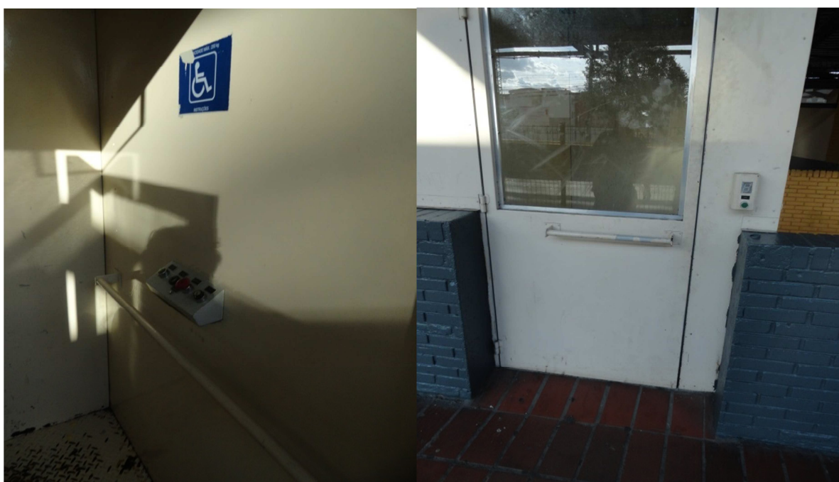
Figura 38 - Plataformas fora da norma ABNT NBR 90050/2015 Fonte: Autor (2016)
