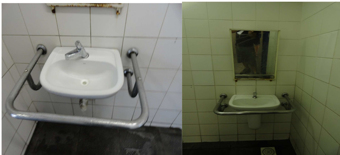
Figura 51 - Lavatórios Verificados Fonte: Autor (2016)
