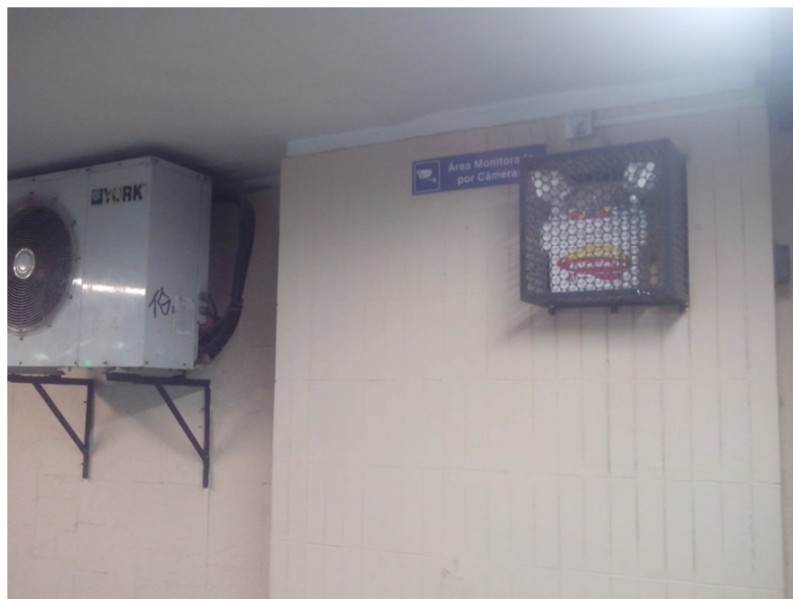
Figura 26 - Sinalização Emergência Fonte: Autor (2016)
