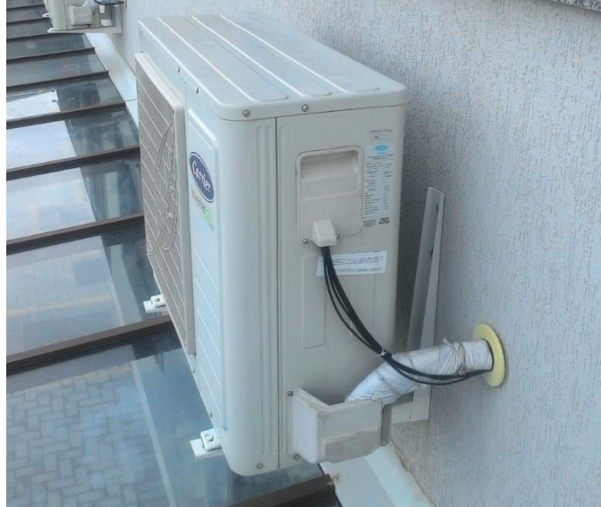
Figura 22 - Foto da Condensadora da Evaporadora (CD 060) FONTE: O Próprio Autor (2019).
