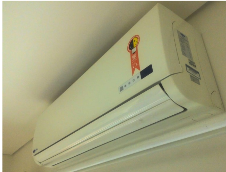
Figura 19 - Foto Evaporadora (EV 061) FONTE: O Próprio Autor (2019).
