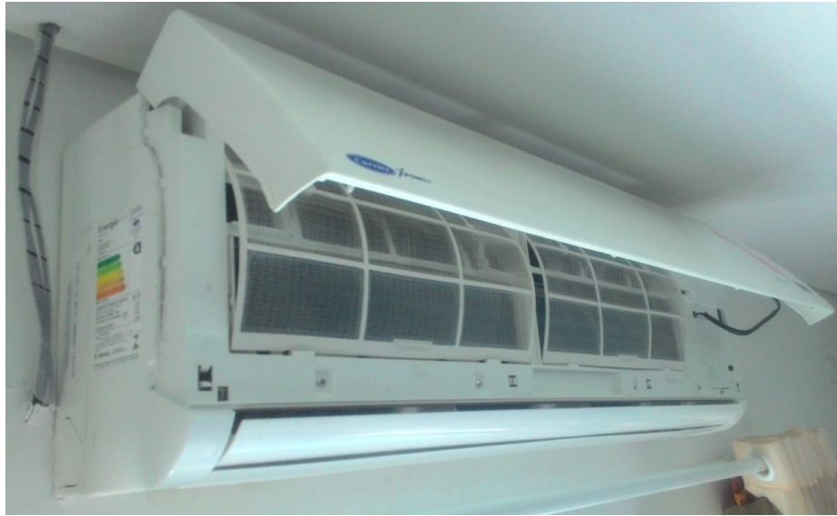
Figura 20 - Foto da Evaporadora (EV 060) FONTE: O Próprio Autor (2019).
