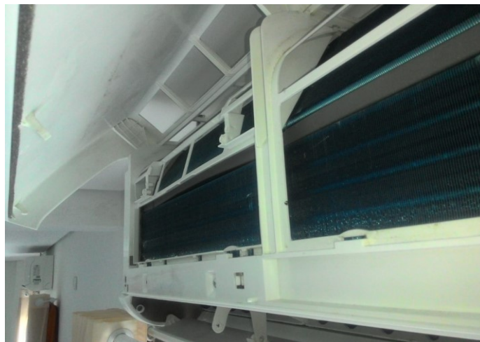
Figura 23 - Foto da Serpentina da evaporadora (EV 061) FONTE: O Próprio Autor (2019).
