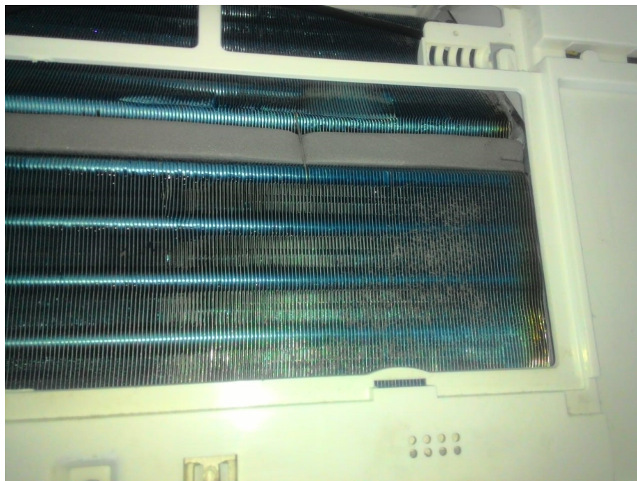
Figura 21 - Foto da Serpentina da evapora (EV 060) FONTE: O Próprio Autor (2019).
