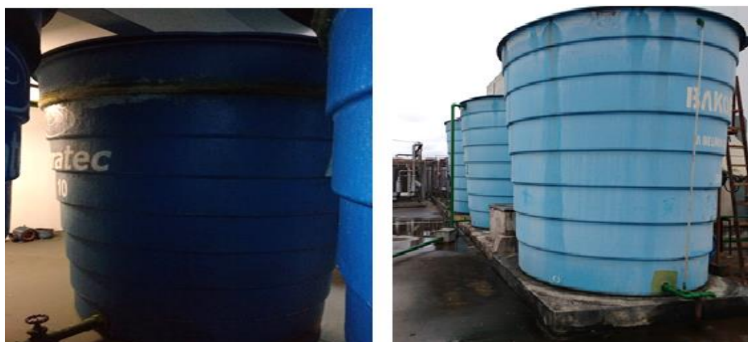
Figura 8- Caixas d'Água em Fibra de Vidro. Fonte: Elaborado pelo autor.
