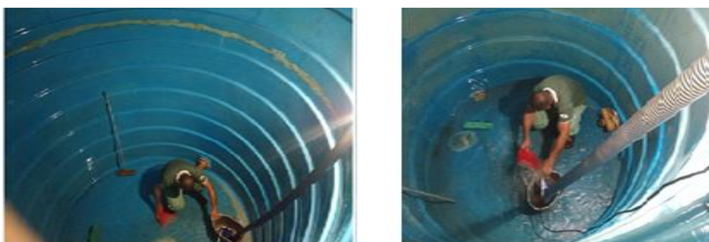
Figura 17- Posição Agachada do Operador Durante a Higienização do Reservatório de Água. Fonte: Elaborado pelo autor.
