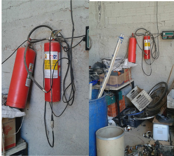
Figura 6 - Associação só possuía dois extintores de incêndio, sem inspeção e manutenção, sem sinalização e localizados em local totalmente obstruído.
