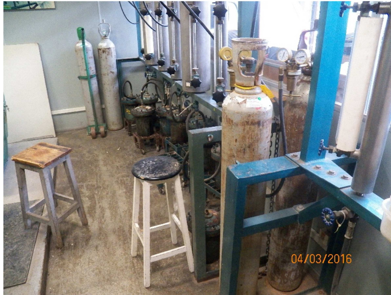
Figura 24– Os recipientes contendo gases comprimidos devem ser armazenados em depósitos bem ventilados Fonte: O autor (2016)
