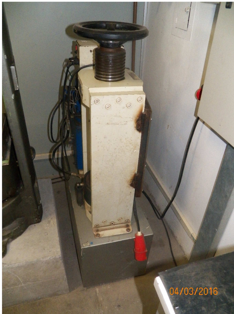
Figura 27– Falta de sinalização de perigo nas máquinas Fonte: O autor (2016)
