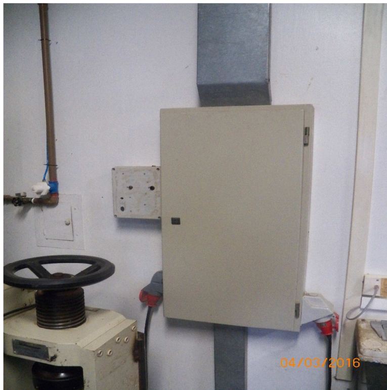
Figura 16– Quadro de energia das máquinas do laboratório Fonte: O autor (2016)
