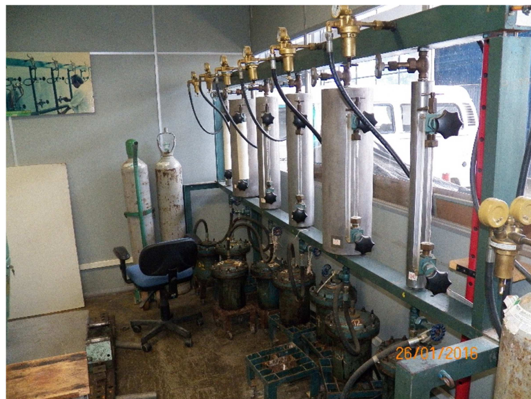
Figura 29– Ausência de sistema de aterramento nas máquinas Fonte: O autor (2016)
