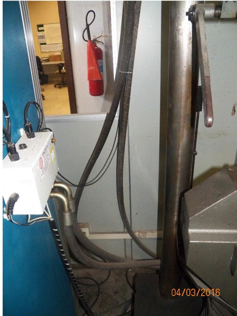
Figura 23– Ausência de proteção nas mangueiras, tubulações e demais componentes pressurizados Fonte: O autor (2016)
