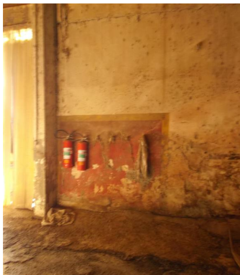
Figura 19: Bateria de extintores em uma entrada do armazém
