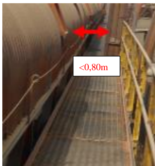
Figura 16: Circulação obstruída em uma correia transportadora
