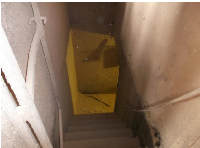
Figura 17: Acesso ao túnel sem corrimão nas paredes
