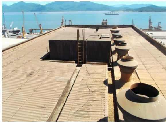
Figura 20: Vista externa do sistema de exaustão do silo vertical
