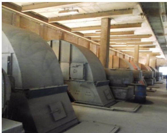
Figura 21: Vista interna do sistema de exaustão do silo vertical
