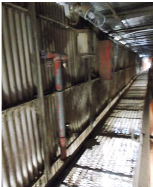
Figura 18: Falta de sinalização nos equipamentos
