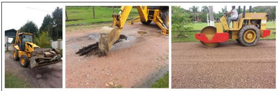
Conjunto de fotografias 12. Detalhes da empresa prestadora de serviços de construção e manutenção da infraestrutura dos modais de estradas do Condomínio Recanto das Hortênsias.
