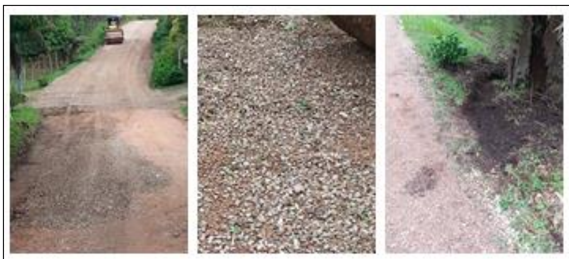
Conjunto de fotografias 46. Operações de pavimentação no ponto 1 da Área 2 do experimento desta pesquisa.
