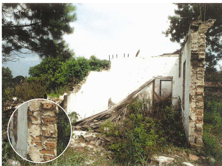
Figura 9. Edificação em ruínas
