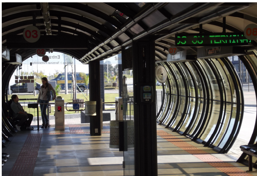
Figura 26. Sistema de ar-condicionado - Estação Tubo Santa Bernadethe.
