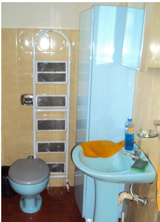
Fotografia 2 - Instalação sanitária setor administrativo Fonte: Autoria própria
