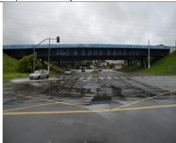
Falta drenagem urbana e sinalização semafórica para o pedestre.
