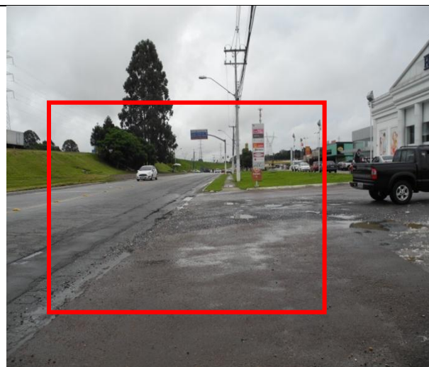
Sinalização deficiente dos acessos. Pavimento em péssimas condições
