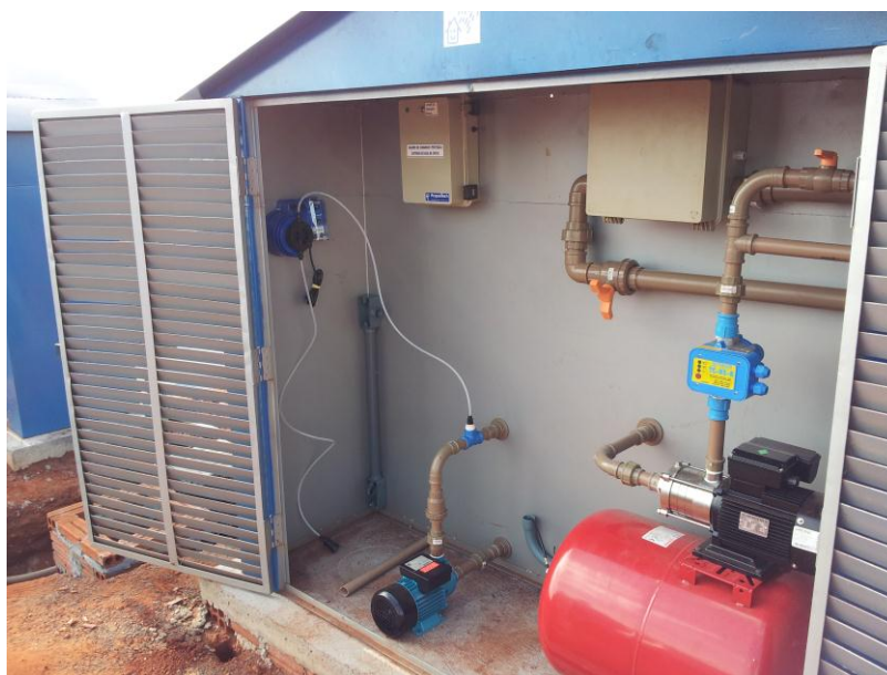
Figura 29: Dosador de cloro instalado na parede Fonte: CARNIEL, 2012.
