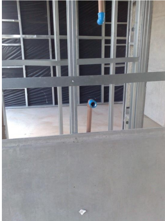
Figura 8: Instalações hidráulicas em edificação de steel frame Fonte: COHAB-CT, 2012.
