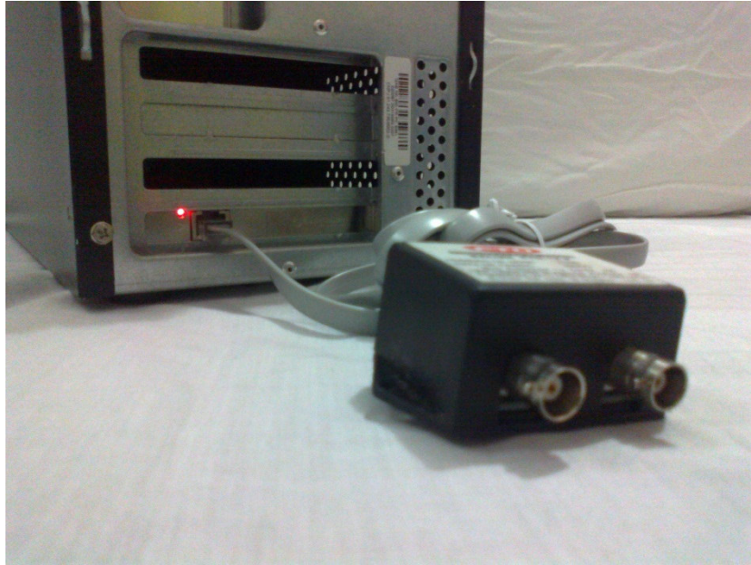
Figura 42: Led indicativo de alarme na placa Sangoma A101 Fonte: Autoria própria
