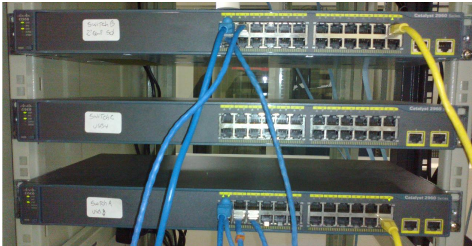
Figura 15 - Switches reais com STP desativado
