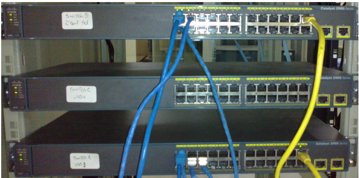
Figura 19 - Switches reais com STP habilitado
