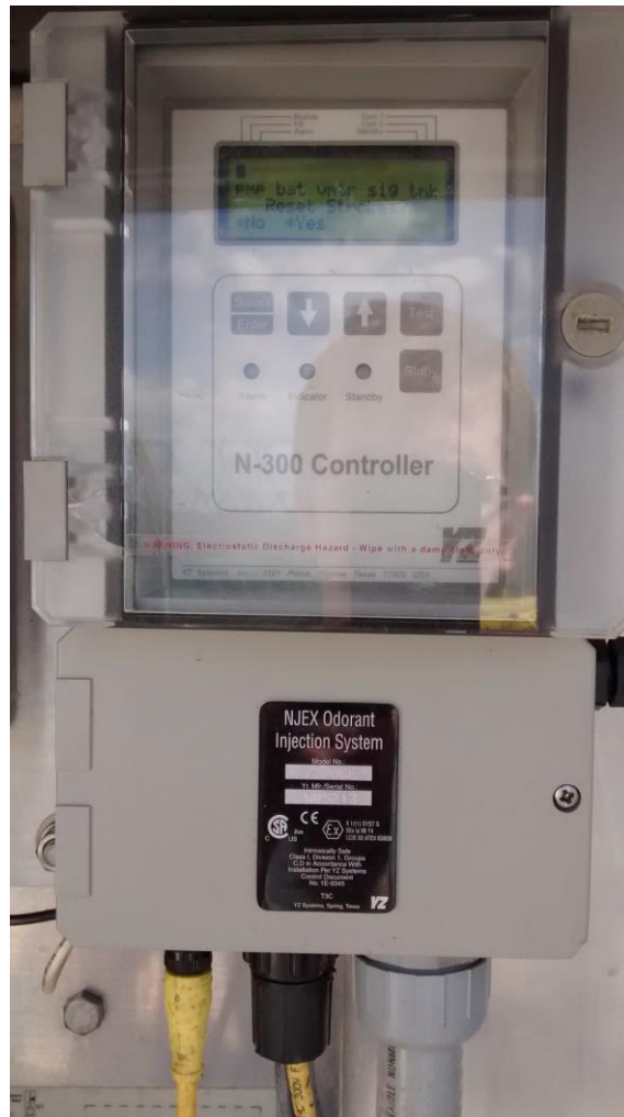
Figura 4 – Controlador N-300G instalado no City Gate de Araucária.
