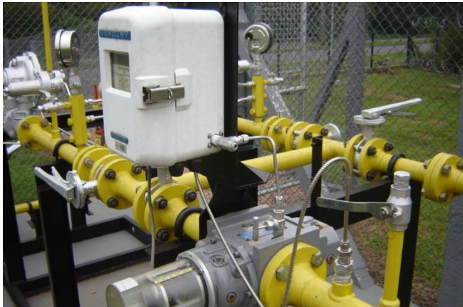
Figura 6 – Corretor de vazão Mini-AT em uma Estação de Regulagem e Redução de Pressão. Fonte: Autoria própria
