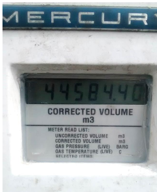
Figura 18 – Corretor de vazão indicando a vazão instantânea.
