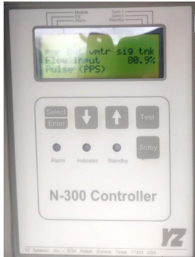
Figura 19 – Controlador N-300G indicando o sinal de vazão de 80,9%.
