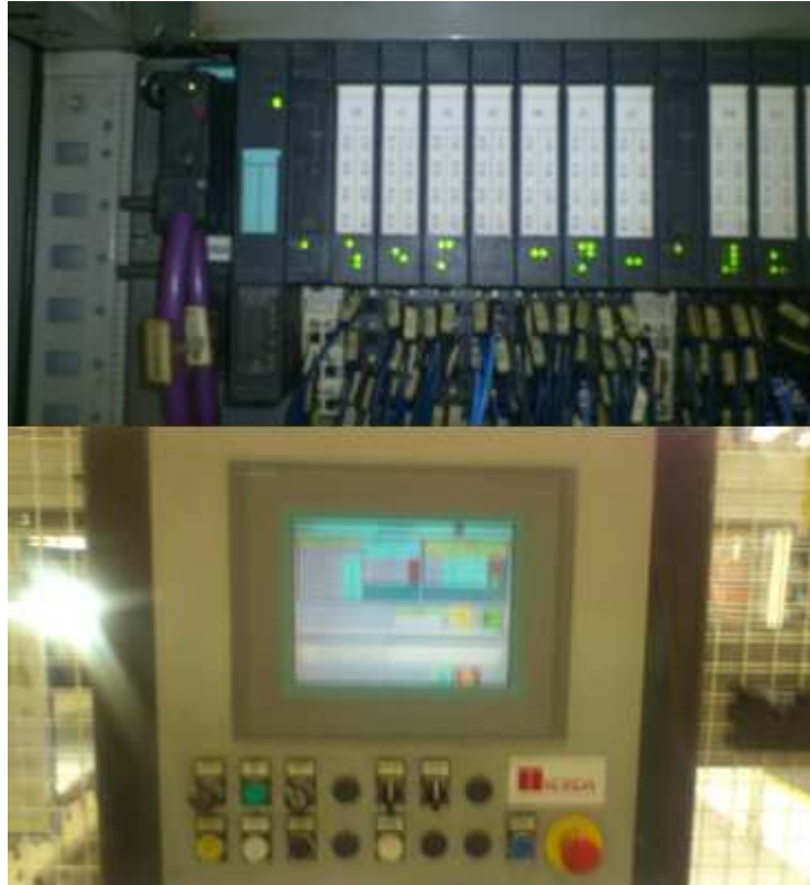
Figura 16- Cabo de rede Profibus com CLP e Painel View ( IHM). Fonte: AUTORIA PRÓPRIA.
