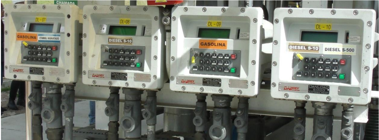
Figura 25 - Pré Determinadores instalados no skid de carregamento FONTE: PRÓPRIA, 2016.
