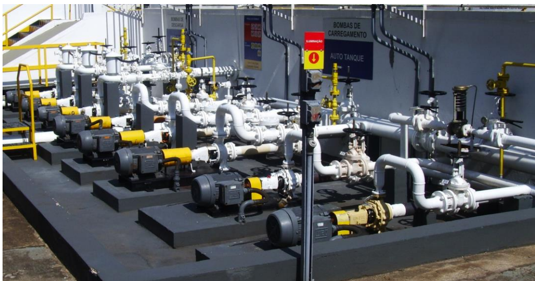
Figura 13 - Praça de bombas FONTE: AUTORIA PRÓPRIA, 2012
