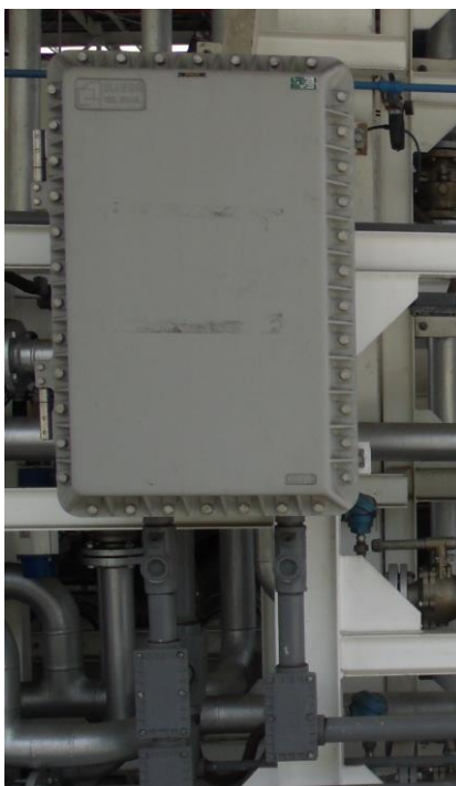
Figura 27 - Caixa de Junção do Skid FONTE: PRÓPRIA, 2016.
