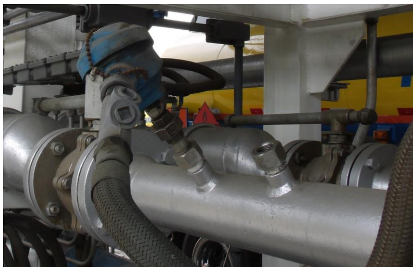
Figura 6 - PT-100 Instalado na linha de produto FONTE: AUTORIA PRÓPIA, 2015
