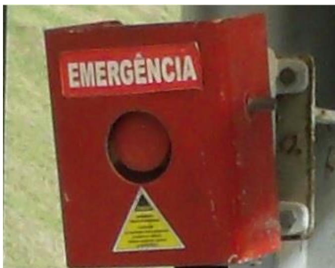
Figura 21 - Botoeira de Emergência FONTE: PRÓPRIA, 2016
