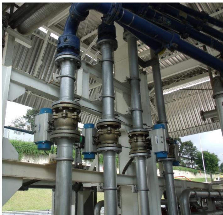
Figura 20 - Válvula de Controle no Braço de Carregamento FONTE: PRÓPRIA, 2016
