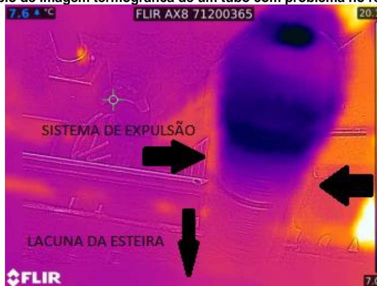
Figura 5- Exemplo de imagem termográfica de um tubo com problema no recrave da válvula.
