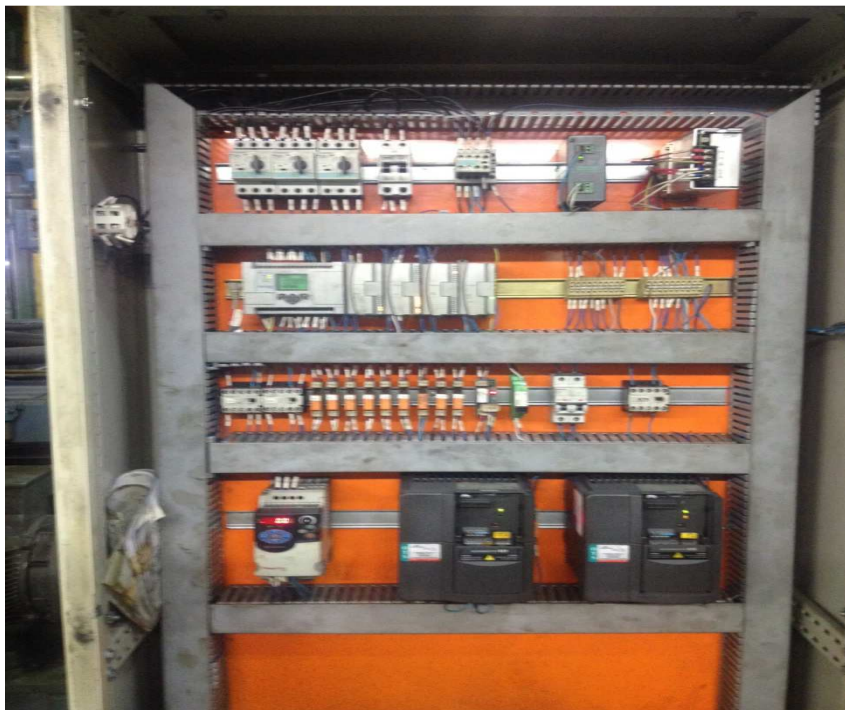
Figura 22: Painel elétrico do dosador
