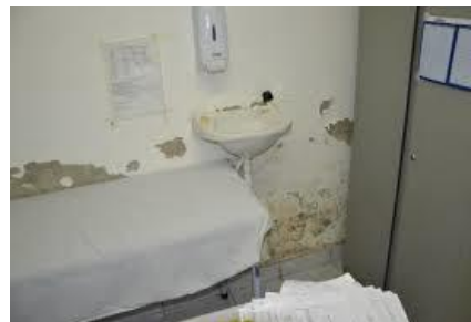
Figura 06 - Mofo em parede.
