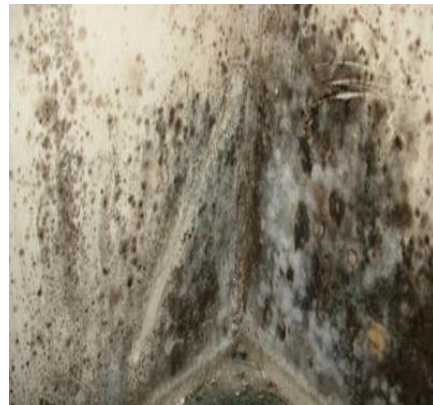
Figura 04 - Mofo em paredes de casas.
