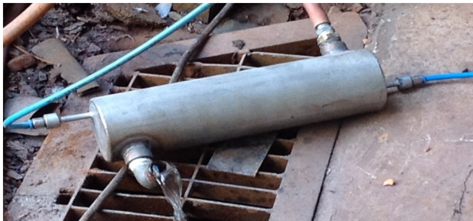
Figura 14 - Trocador de calor, sem revestimento térmico, em fase de teste de funcionamento.
