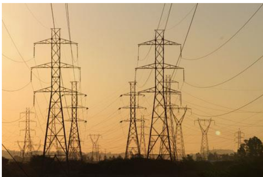
Figura 9 - Extensão de duas linhas de transmissão de energia elétrica. Fonte: Jornal do Comércio (2015)
