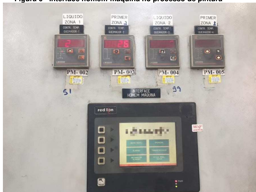
Figura 6 - Interface homem-máquina no processo de pintura
