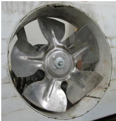
Fotografia 4 – Ventilador de convecção Fonte: Autoria Própria
