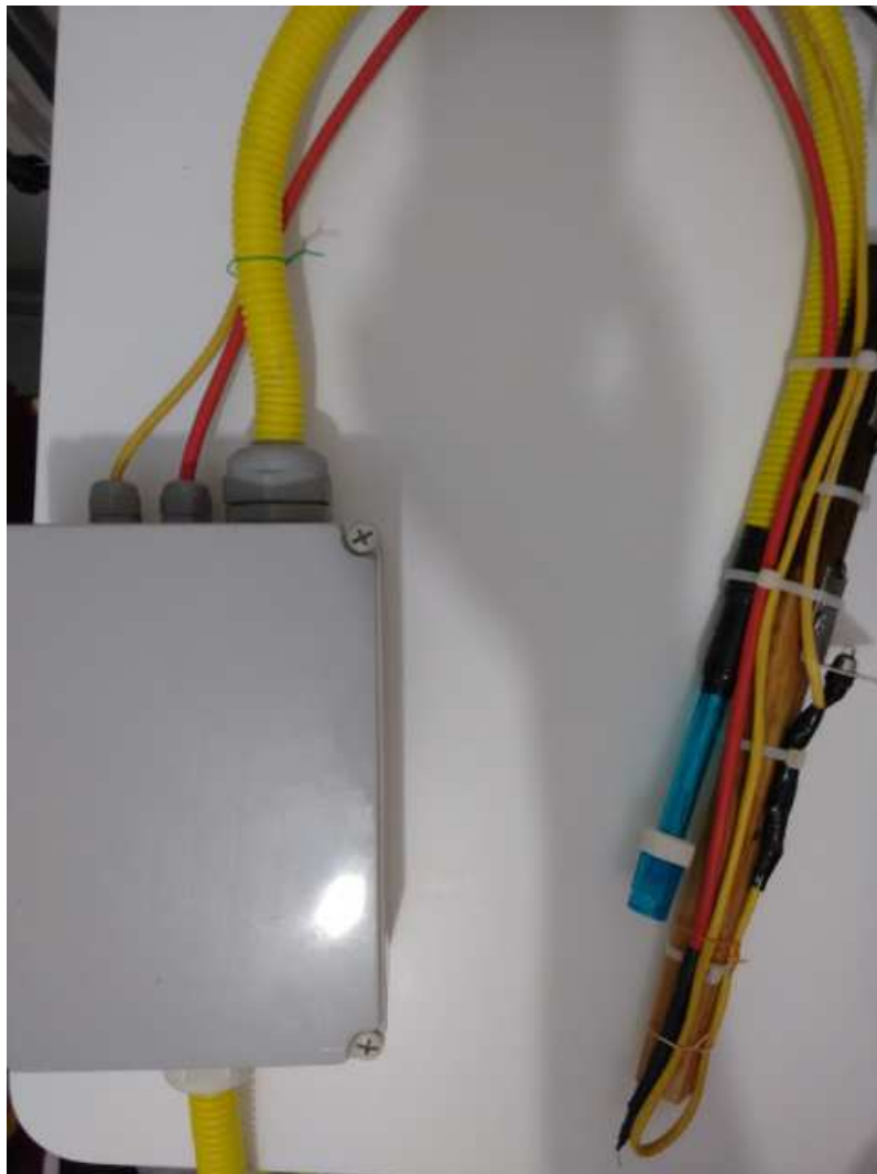
Figura 10: Caixa de derivação
