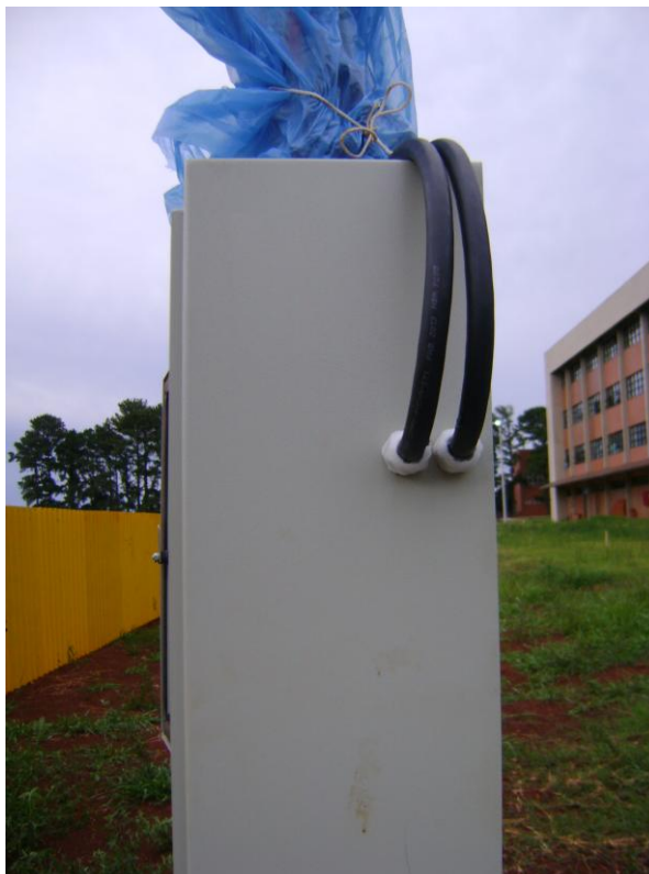
Fotografia 27 - Detalhe da entrada dos cabos do Seguidor Solar. Fonte: Autoria própria.
