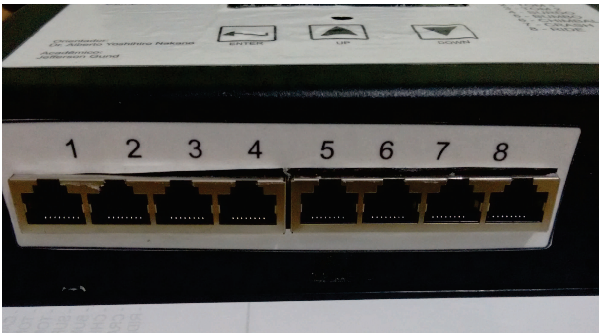
Figura 33: Detalhes dos conectores RJ45.
