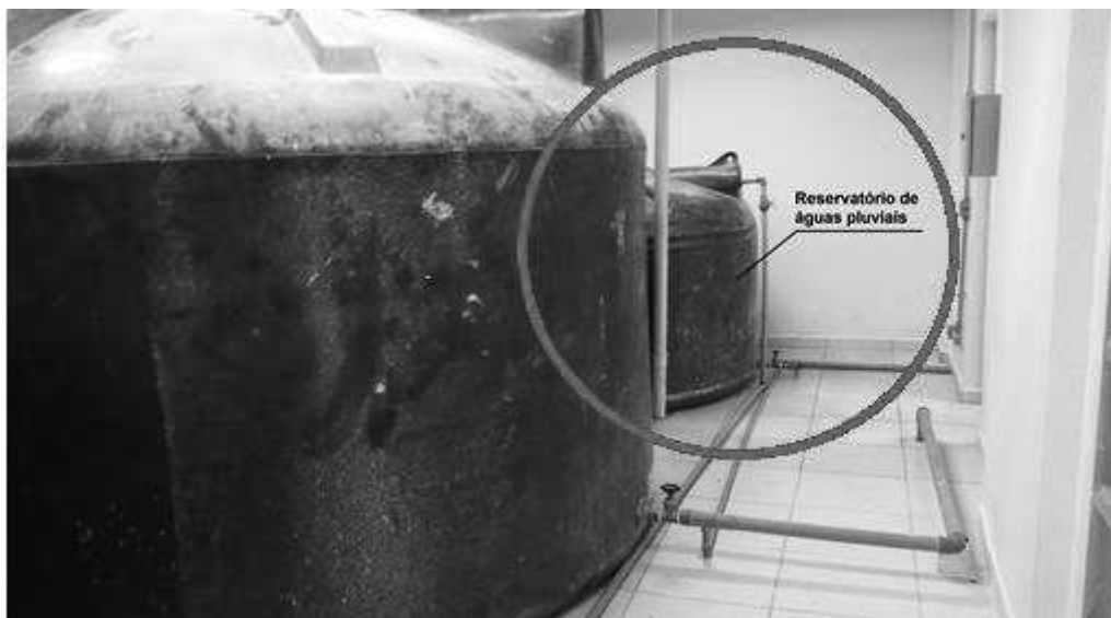
Figura 16: Reservatório pluvial apoiado na laje. Fonte: Autoria própria (2017).
