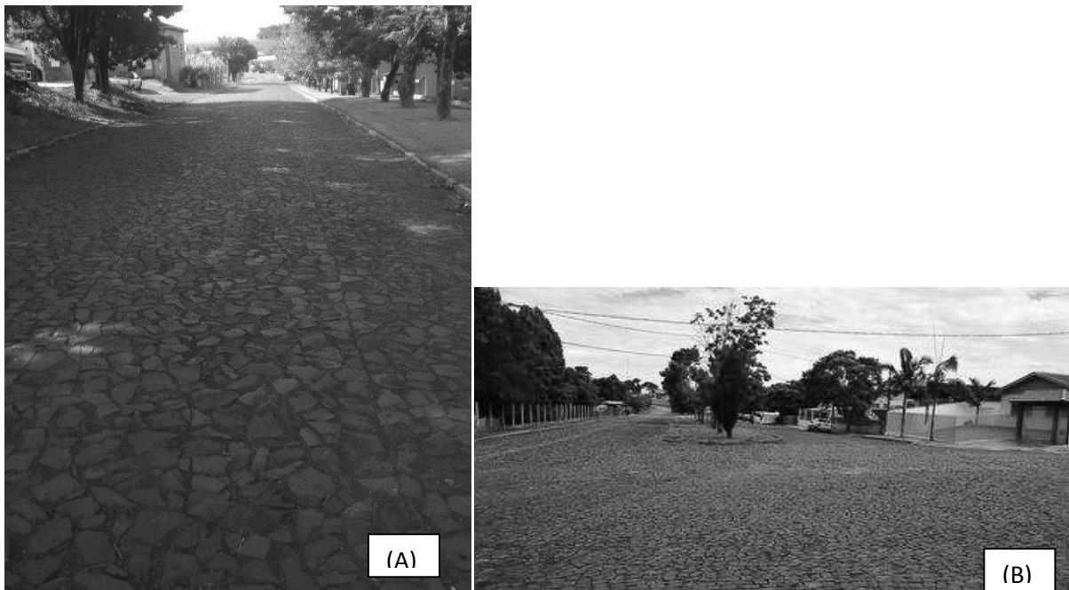
Figura 6 - Revestimento em Alvenaria Poliédrica (A) Toledo-PR e (B) Capitão Leônidas Marques PR 1
