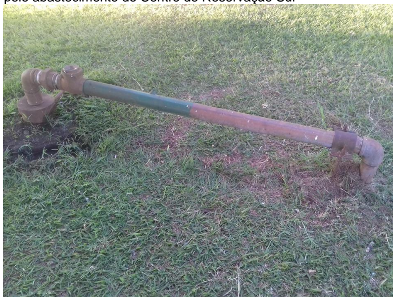
Figura 4.9 – Adutora de água bruta e um dos poços responsáveis pelo abastecimento do Centro de Reserva Sul
