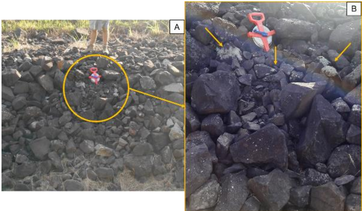
Figura 10 - Presença de líquen na área de alteração na Estaca 136+50. (A) Vista geral do talude. (B) Detalhe.
