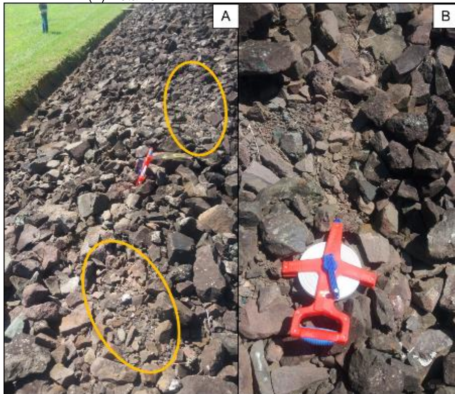
Figura 13 – Área de alteração na Estaca 127+60, alteração na linha divisória entre patamar e talude. (A) Visão geral do patamar. (B) Detalhe.
