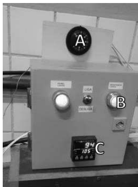
Figura 14 - Painel de controle de temperatura Fonte: A autora (2017).
