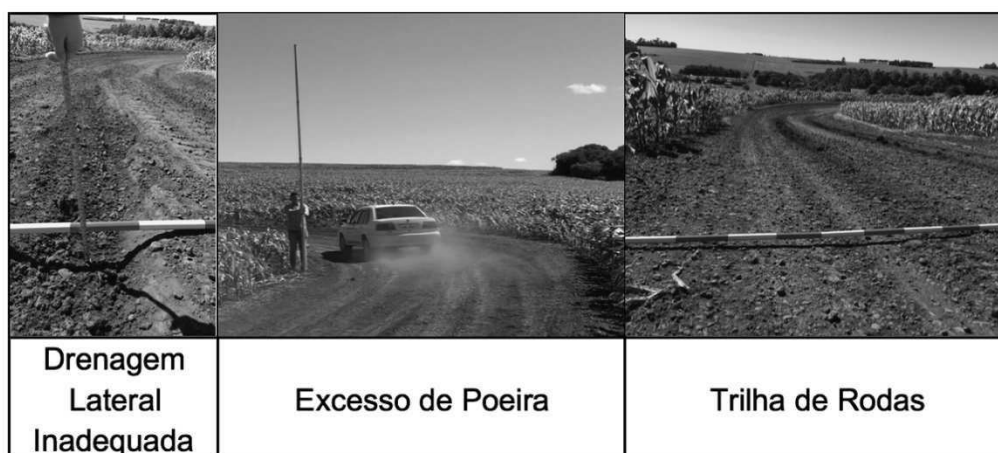
Figura 43 – Defeitos encontrados na Subseção 2
