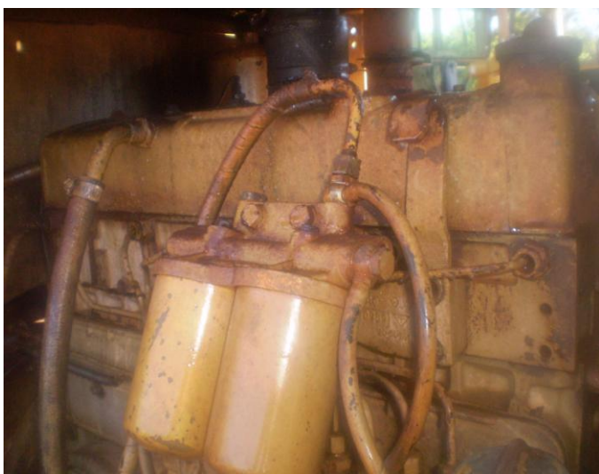
Figura 05: Filtros primário e secundário.
