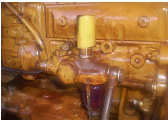
Figura 04: Bomba de sucção.
