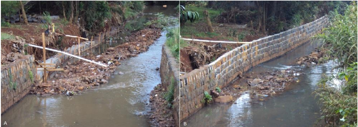
Figura 23 – Obras de canalização a) Leito do rio em Outubro 2010 b) Mesmo ponto em Maio de 2011 Fonte: Autor
