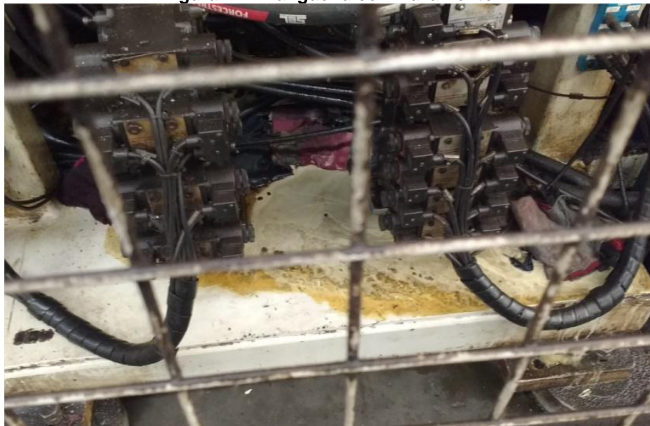
Figura 22 - Mangueira com vazamento.
