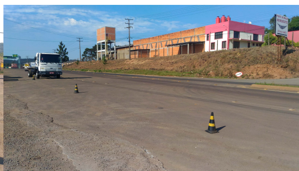
(b) Pista de 20 metros.
