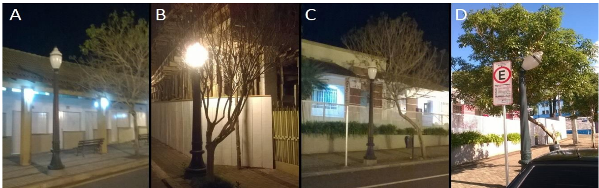
Figura 13 - Luminárias apresentando defeito no cenário 1
