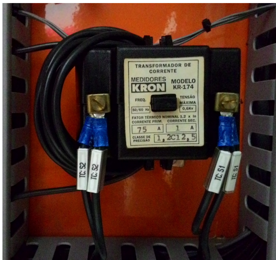
Figura 8: Transformador de corrente, para medição. Fonte: Autorial Própria
