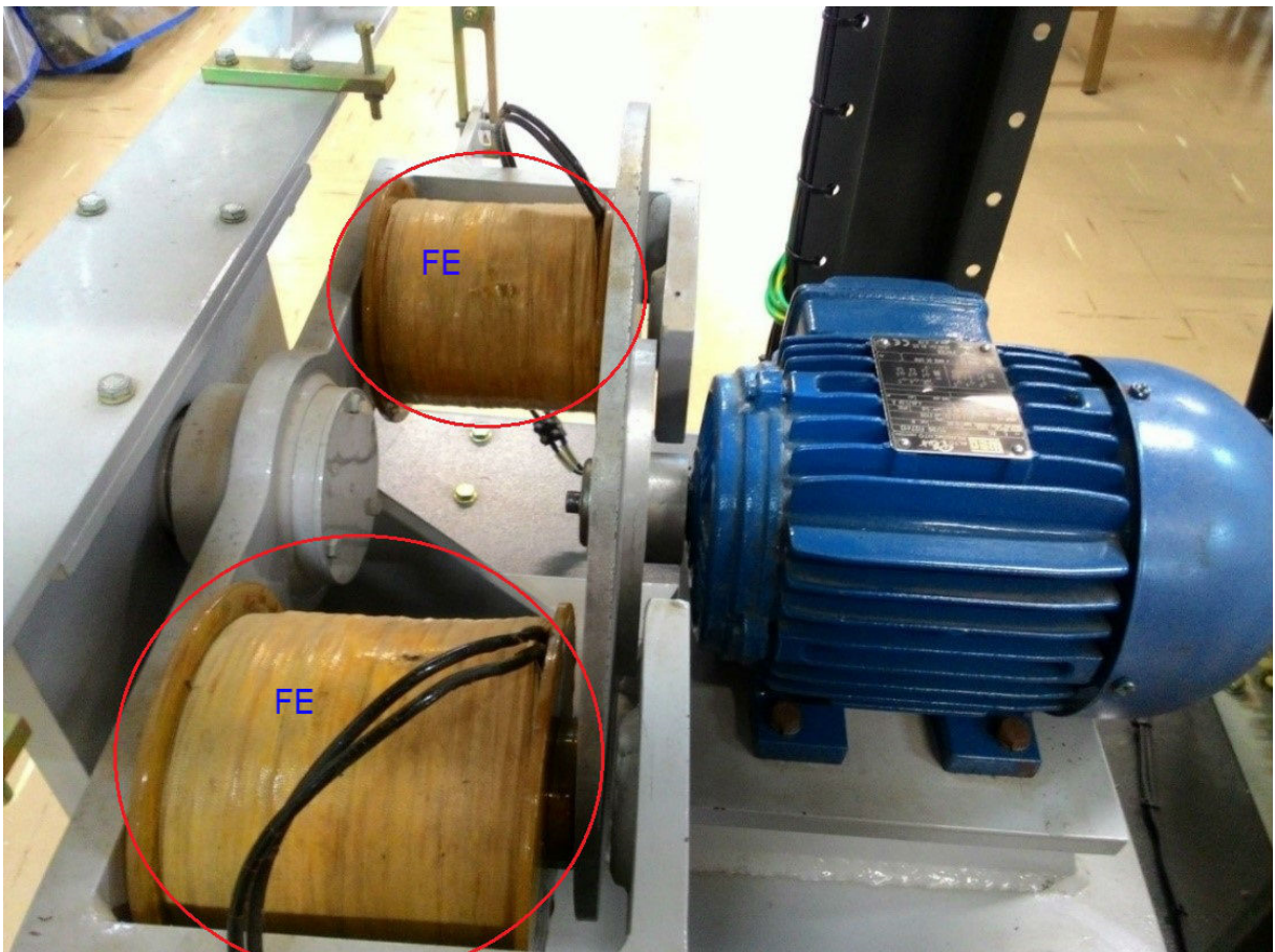
Figura 9: Bobinas de freio eletromagnético, e MIT Fonte: Autoria Própria.
