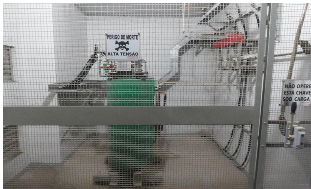
Figura 17 - Cubículo do Transformador de 500kVA Fonte: Autoria Própria
