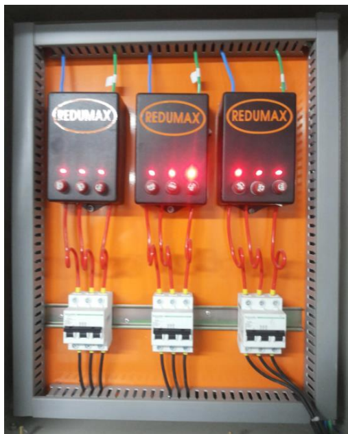
Figura 19 - Filtro de Energia Elétrica Redumax - RX2000 Fonte: Autoria Própria
