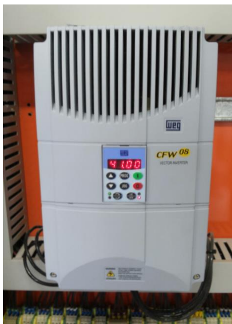
Figura 22 - Inversor de Frequência Responsável Pelo Acionamento e Controle do Motor – Exaustor do Pó do Sessor.
