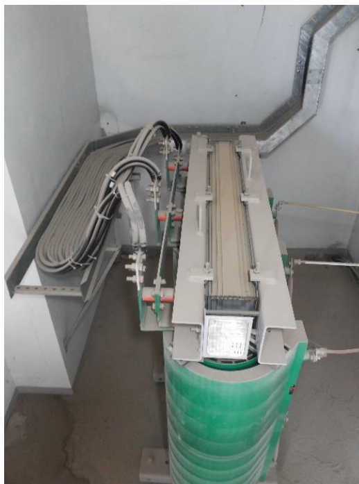
Figura 67 - Vista Superior do Transformador de Alimentação Fonte: Autoria Própria
